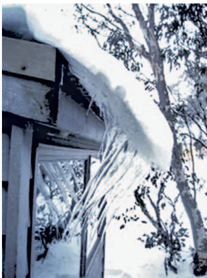
Rys. 1. Śnieg i nawisy śnieżne zalegające na dachach łukowych
