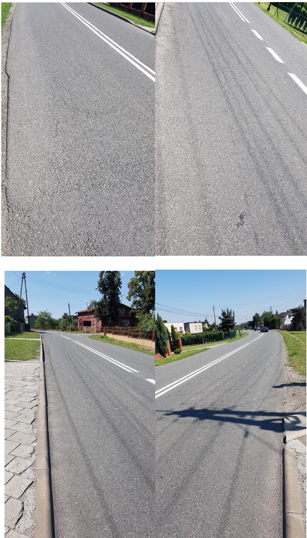
Rysunek 6.21. Przykładowe spękania nawierzchni na poligonie badawczym A na odcinku nr 3 – 2019 (zdjęcie własne)
