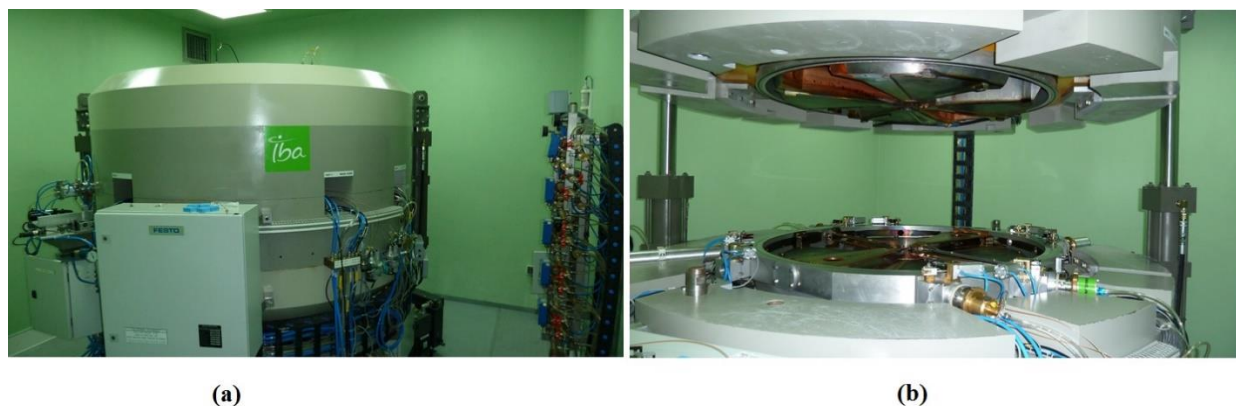
Rysunek 6.4. Cyklotron Cyclone 18/9 firmy IBA zainstalowany w Centrum Onkologii-Instytucie im. Marii Skłodowskiej-Curie, Oddział w Gliwicach. (a) cyklotron gotowy do pracy, (b) otwarty cyklotron przygotowany do prac serwisowych.
