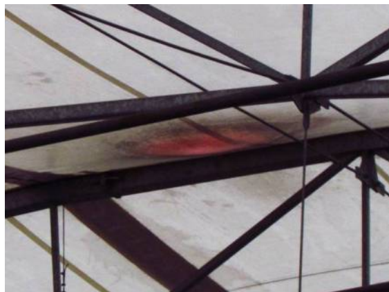
Il. 339. Rozwój glonów w miejscu zastoju
