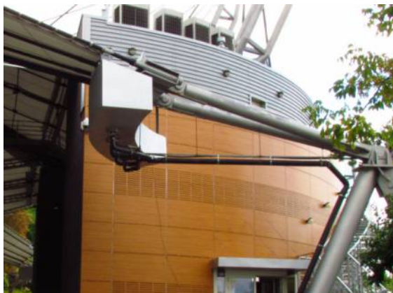
Il. 303. Podciśnieniowy system rur spustowych w Płocku
