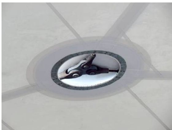
Il. 267. Otwór w membranie pętli autobusowej w Warszawie
