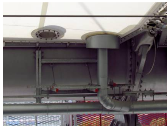
Il. 297. Odprowadzenie wody na Stadionie Narodowym w Warszawie
