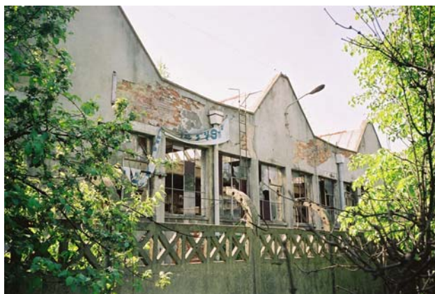
Fot.34. Oświęcim, ulica Leszczyńskiej. Była hala Zakładów Kruppa (przekształcona po wojnie, obecnie nieużytkowana i niszcząca). Ujęcie w kierunku płn.-zach.
