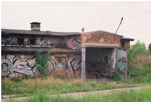
Fot.12.Brzezinka. Opuszczone i dewastowane ziemniaczarki przy Judenrampie. Ujęcie w kierunku półn.-zach.
