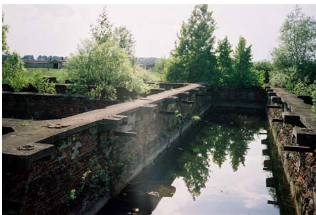
Fot.9. Brzezinka. Niezabezpieczona i niszcząca ruina wodociągów KL Birkenau. W głębi widoczne baraki II odcinka KL Birkenau (obecnie Muzeum). Ujęcie w kierunku półd.-zach.
